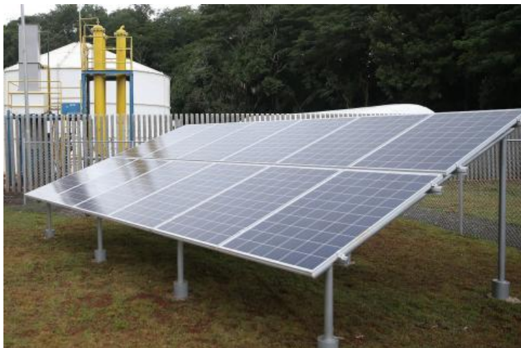
Microusina de energia solar fotovoltaica abastece 70 veículos. Foto: José Cruz/Agência Brasil
