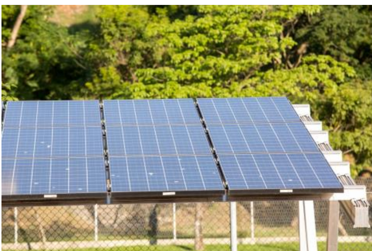
Placas de energia fotovoltaica. Foto: Soninha Vill/GIZ
