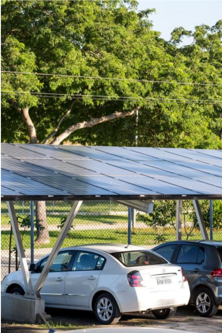
Estacionamento solar na UFRJ. Foto: Soninha Vill/GIZ
