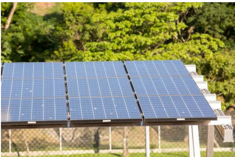
Placas de energia fotovoltaica. Foto: Soninha Vill/GIZ
