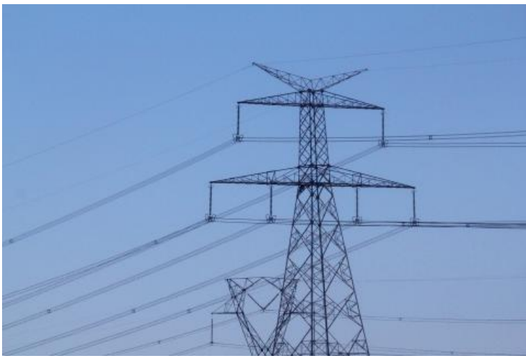
Rede de transmissão de energia. Foto: Marcos Santos/USP imagens
