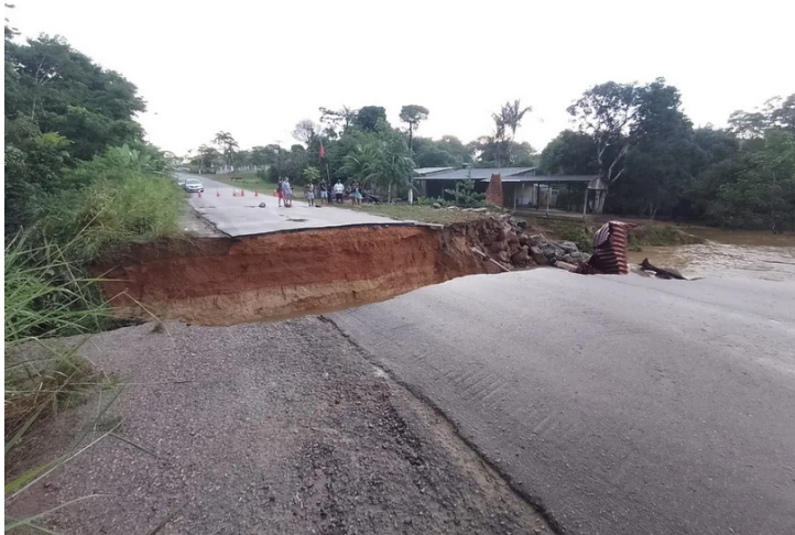
Cratera foi aberta no asfalto com a força das águas após forte chuva em Porto Velho — Foto: Eduarda Dejan/Rede Amazônica
