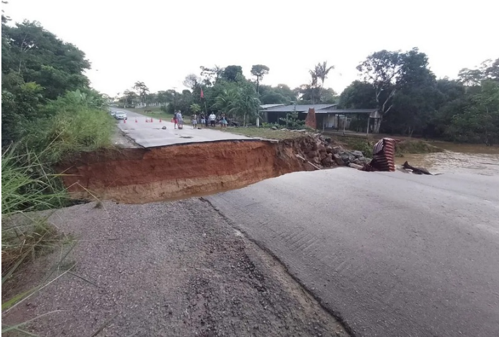
Cratera foi aberta no asfalto com a força das águas após forte chuva em Porto Velho — Foto: Eduarda Dejan/Rede Amazônica
