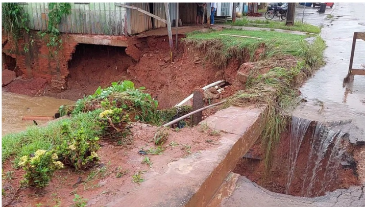
Piso de lavador de carros cedeu após fortes chuvas em Nova Brasilândia — Foto: Matheus Afonso/Rede Amazônica
