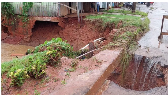
Piso de lavador de carros cedeu após fortes chuvas em Nova Brasilândia — Foto: Matheus Afonso/Rede Amazônica
